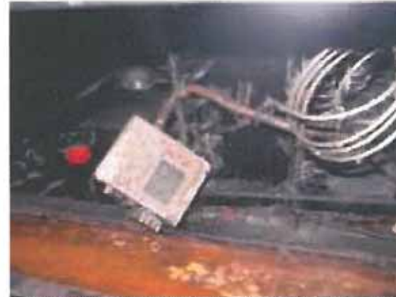
stark verdreckter Aggregatebereich des Tresens
