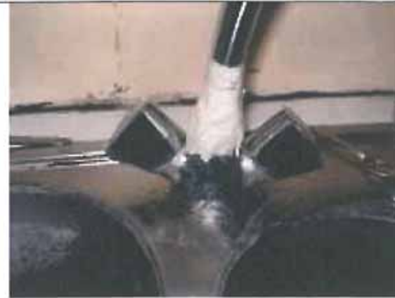
Armatur der Gläserspüle mit Pflaster aus- gebessert, Silikonfugen schwarz
