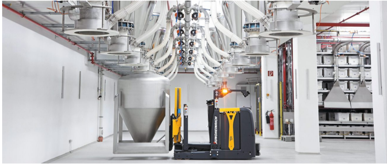
Hochmodern: Im AVO-Werk in Belm werden die Gewürze automatisiert abgewogen und gemischt.
